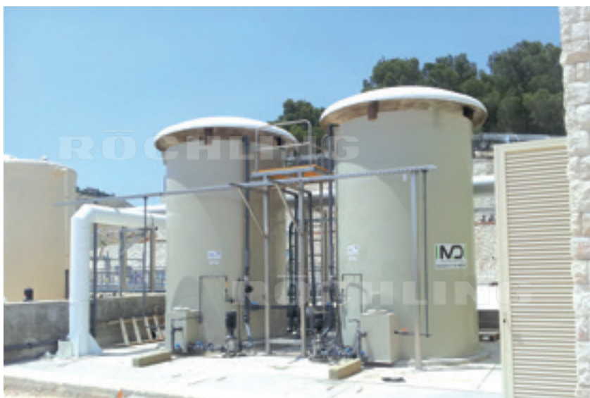
Biofiltro per la neutralizzazione degli odori
