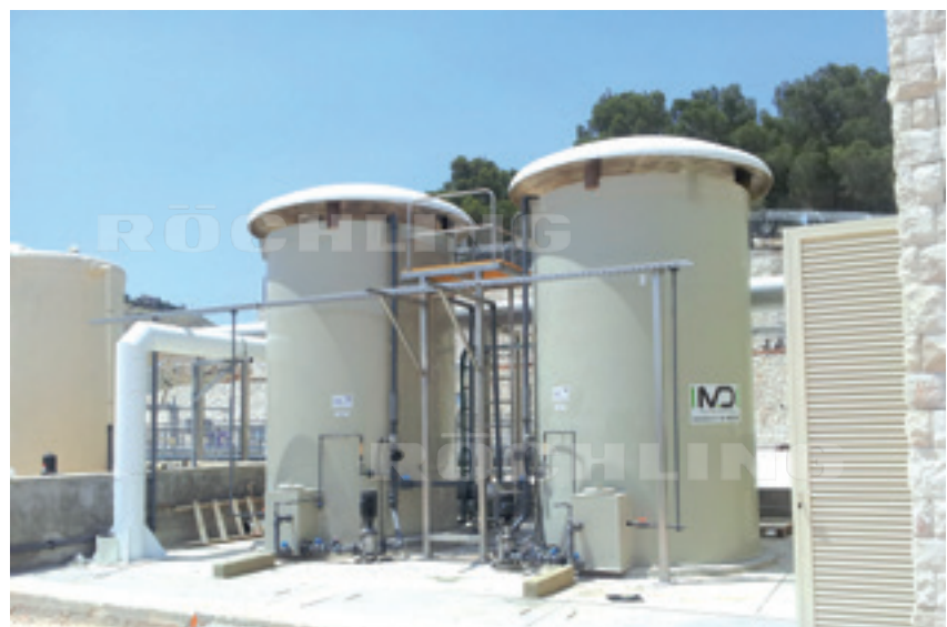
Biofilter zur Geruchsneutralisation
