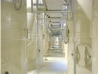
Polystone® P Block-Copolymer grau Rundbehälter in einer Wasseraufbereitungsanlage
