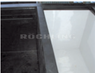
Polystone® PVDF GK Inliner eines Chrombads mit Glasgewebekaschierung
