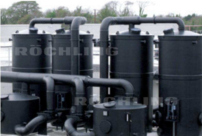
Polystone® G schwarz B 100 Luftreinigungsanlage in einer Wasseraufbereitungsanlage
