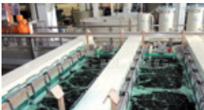
Behälter aus Polystone® P in einer Kunststoffgalvanik
