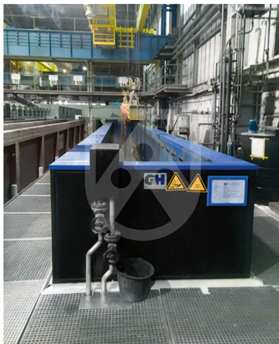
Auskleidung aus Polystone® G blau B 100-RC: Der Werkstoff eignet sich für den dauerhaften Kontakt mit der aggressiven Salpeter- und Flußsäure und trägt zu einer hohen Betriebssicherheit und Leistungsfähigkeit der Anlage bei
