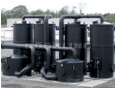
Polystone® G nero B 100 Sistema di depurazione dell'aria in un impianto di trattamento delle acque
